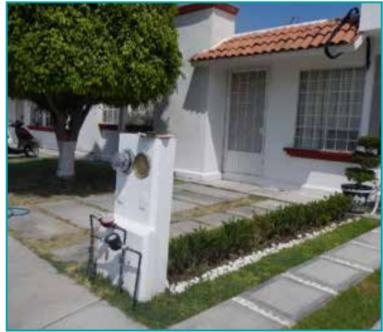
Figura 6.11. Medidores de consumo en cuadro. Medidor clase C y Clase B. De velocidad, tipo turbina.
