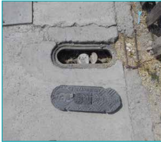
Figura 6.10. Medidor de consumo en banqueta.
