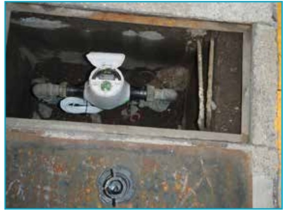
Figura 6.14. Medidor electromagnético para medición de consumos (medidor inteligente). Clase C.
