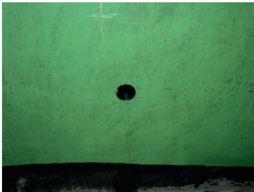
Figura 2.61 Orificio visto desde el exterior del conducto.
