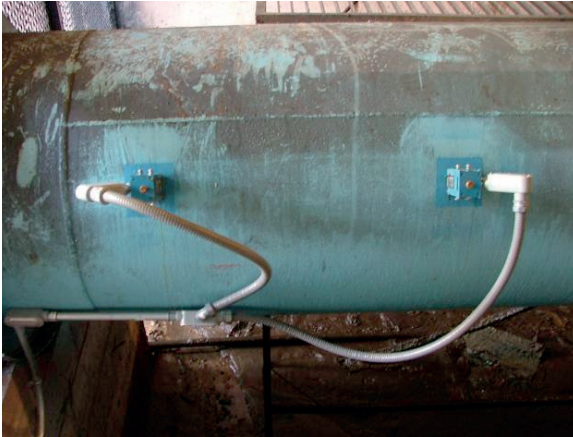
Figura 3.25 Sensores en la tubería en arreglo V.
