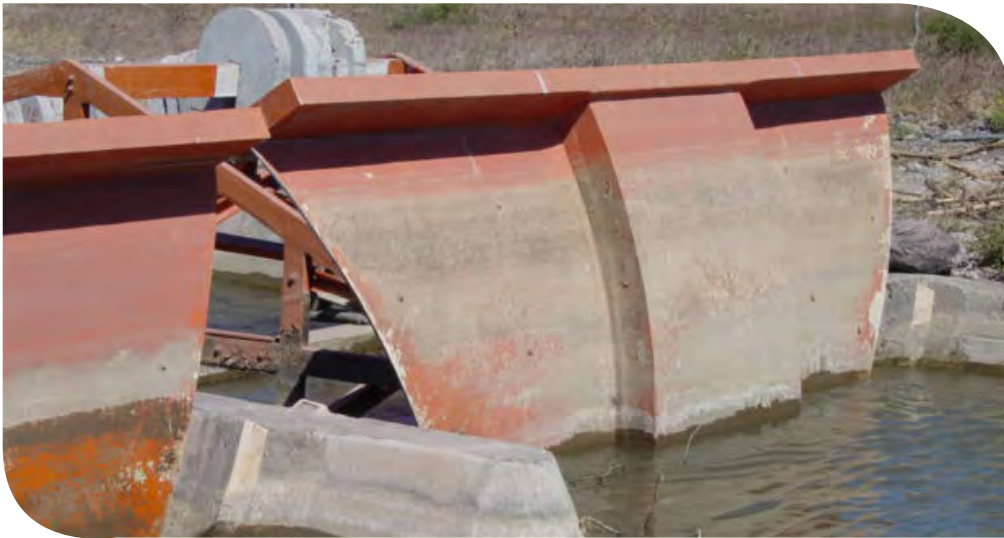
Figura 7.19. Compuerta AMIL metálica. DR053 Estado de Colima, Colima. Fotografía: Ariosto Aguilar Chávez.
