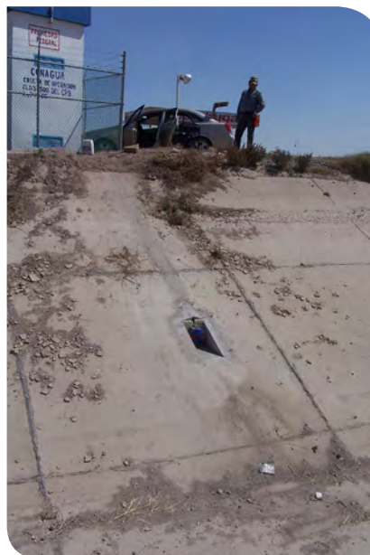
Figura 6.12. Aforador acústico Doppler colocado en el canal lateral 3+500, DR 017 Región Lagunera, Coah.-Dgo.
