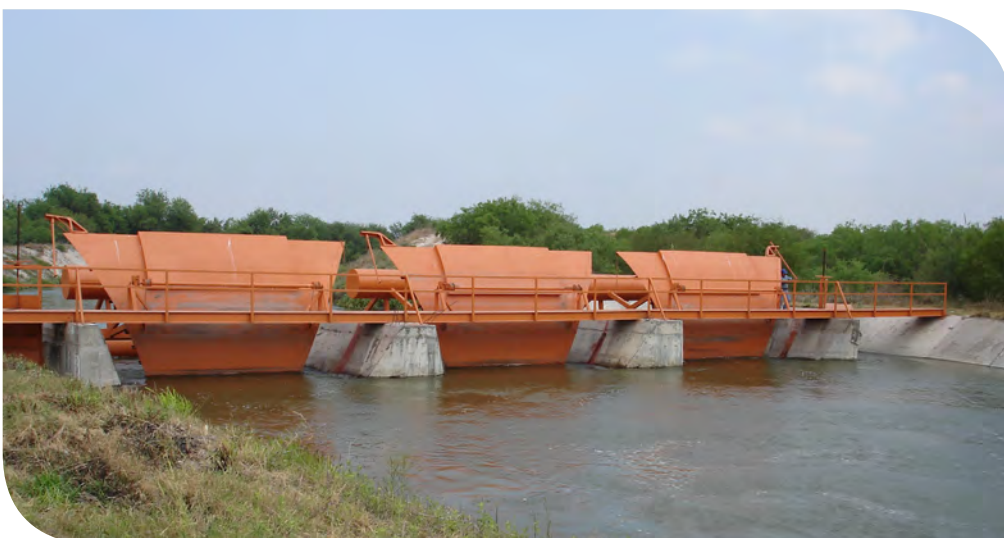
Figura 7.20. Compuertas AMIL en el canal Rode. Fotografía: Ariosto Aguilar Chávez.
