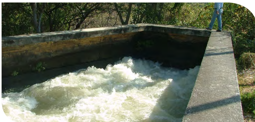
Figura 7.37. Entrada y salida de un sifón invertido, DR097 Lázaro Cárdenas, Mich.
