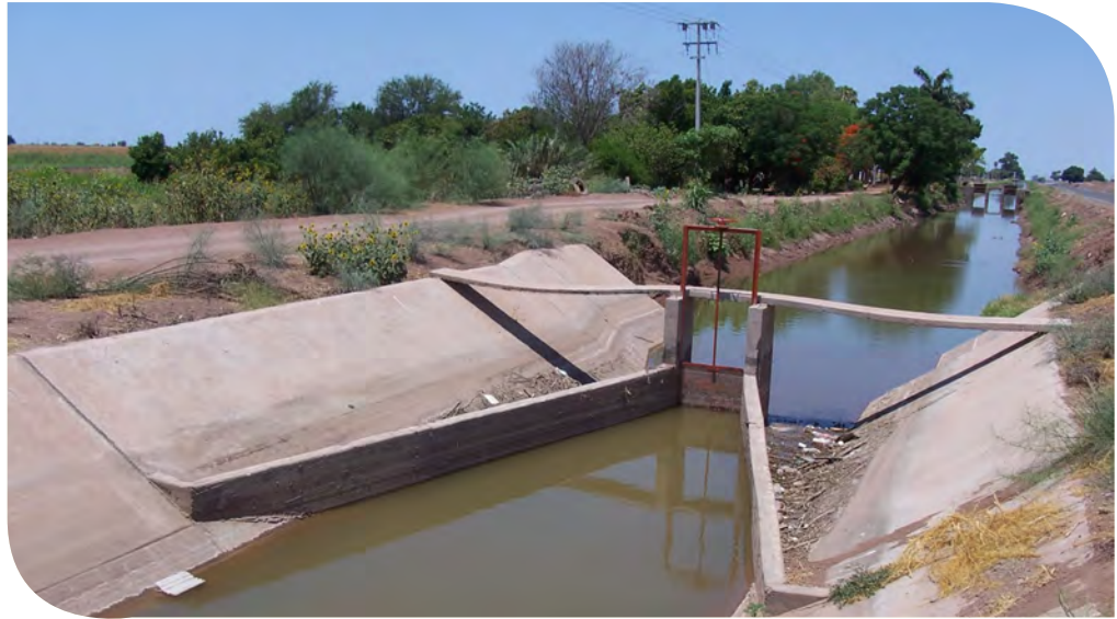
Figura 7.24. Vertedor de cresta larga en el DR041 Río Yaqui, con compuerta plana al frente.
